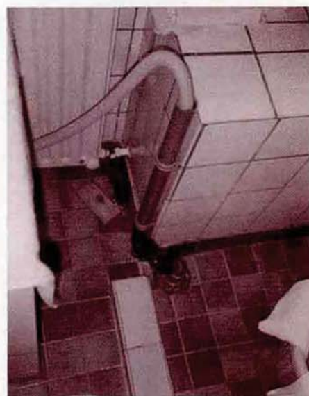
De vloer is een berucht breekpunt bij doucherenovatie. Het verbeteren van het afschot of het verplaatsen van de afvoer is alleen mogelijk door de vloer op te hogen met plaatmateriaal of een douchebak te plaatsen.
